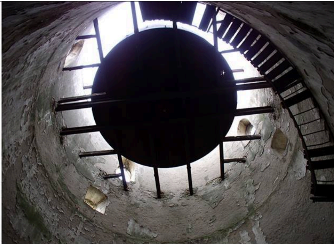
Залишки металевих сходів всередині башти. 2011р.
